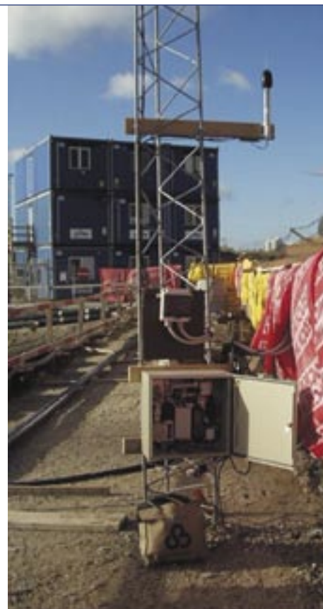
Overvågningssystemets målepunkt med udendørs mikrofon og elektronikskab på Danmarks Radios byggeplads i Ørestaden.
